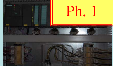
PLCs Siemens S7-300
