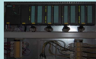
PLCs Siemens S7-300
